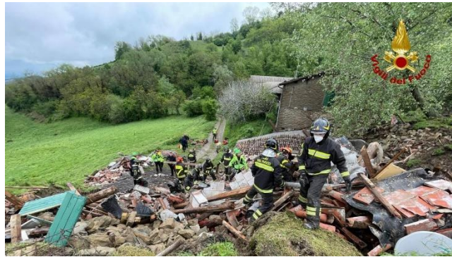
Figura 7 Frana a Fontanelice (BO)
