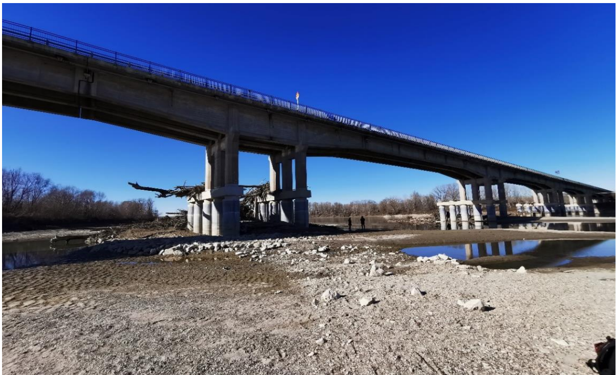
Figura 38 - Accumulo di detriti legnosi di notevoli dimensioni in corrispondenza delle pile del ponte di Boretto
